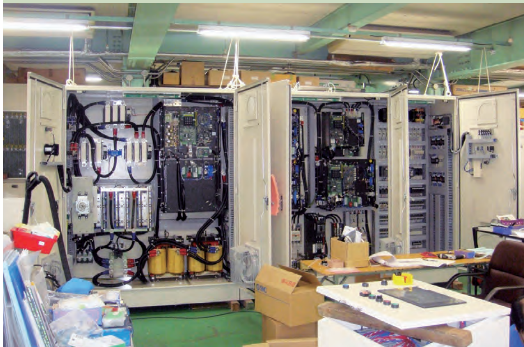
さまざまな機械の制御盤を製造
