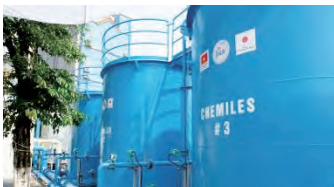
ベトナムで納入した水処理装置「ケミレス」
