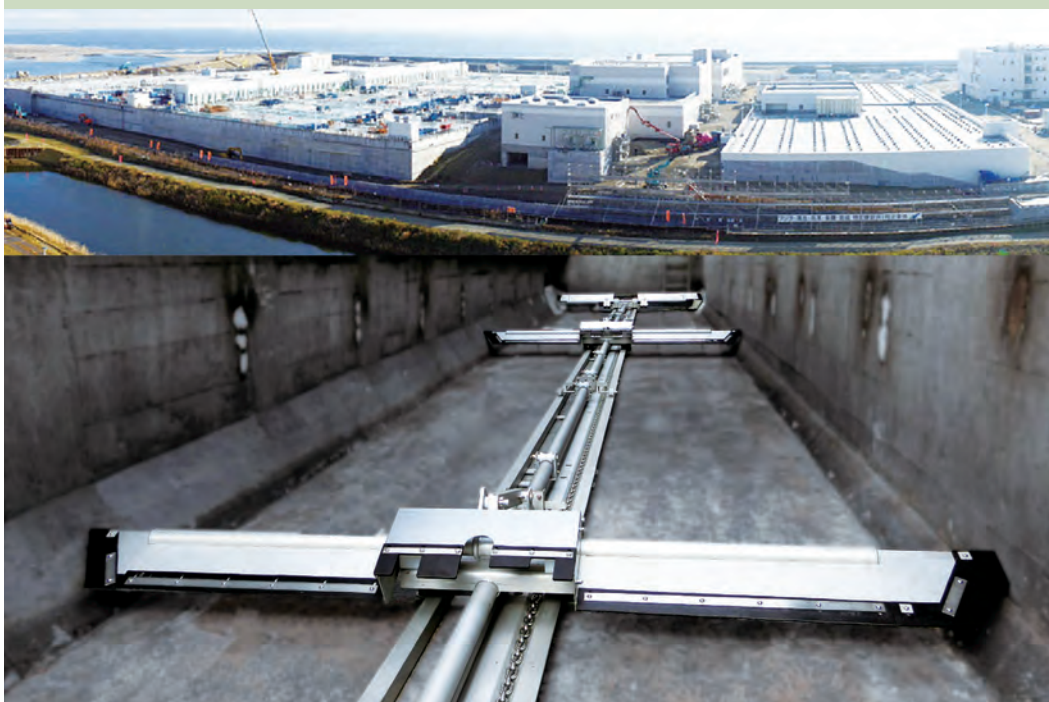
モノレール式汚泥（おでい）かき寄せ機
