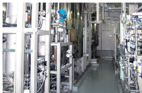
医薬用精製水供給装置
