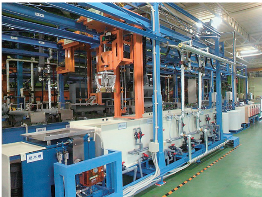
増設したメッキライン装置
