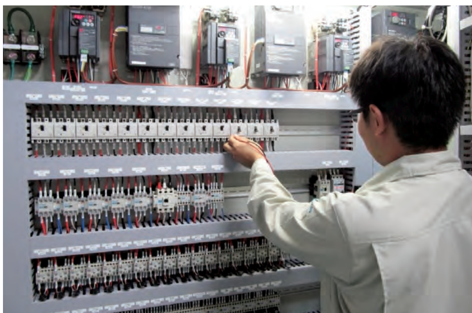
めっき装置で加工品を搬送する動力部の制御盤
